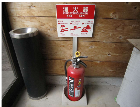
(消火器設置状況)
