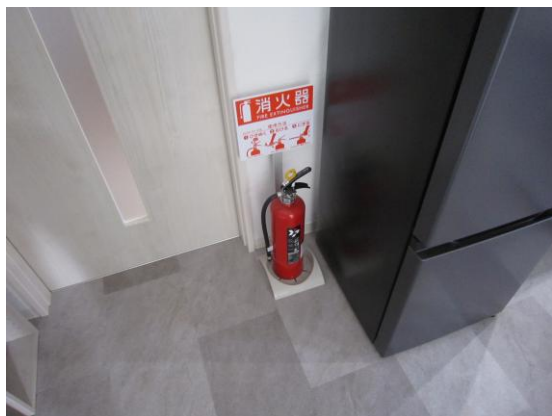
(消火器設置状況)
