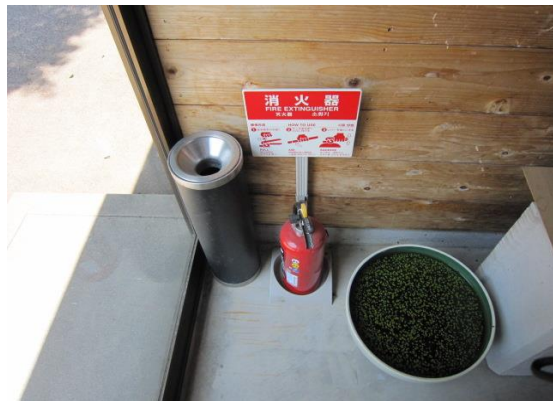
(消火器設置状況)
