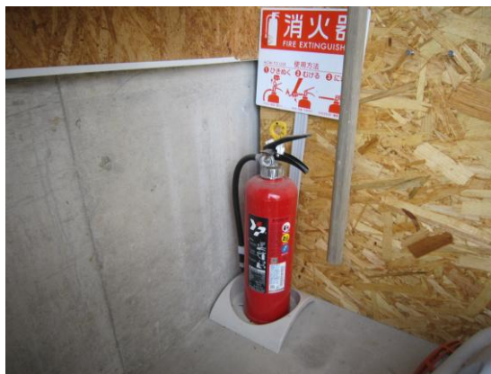
(消火器設置状況)
